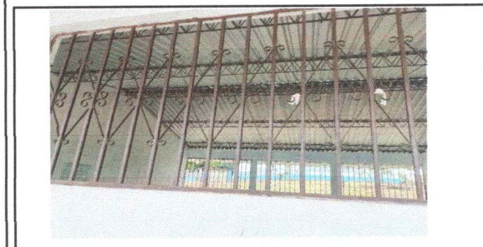
Foto 5: MANTENIMIENTO DE BALCONES: SE NECESITA EL MANTENIMIENTO DE LOS BALCONES (APLICACIÓN DE ANTICORROSIVO)
