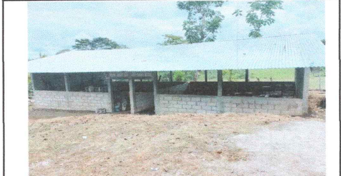
Foto 2: CERNIDO, PINTURA Y PUERTAS. EL MÓDULO CARECE DE CERNIDO, PUERTAS, BALCONES, Y PINTURA.
